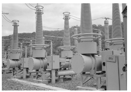
写真1 275kV 超高圧変電所(インドネシア)
